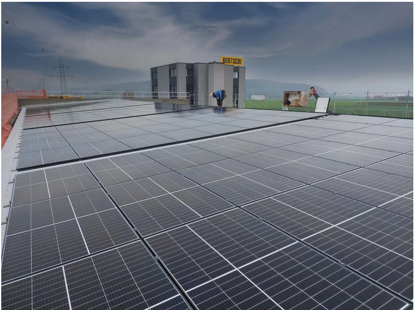
Bertschi hat im Birrfeld drei neue Photovoltaikanlagen errichtet.
